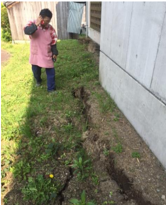
田上会員自宅裏の地割れ
